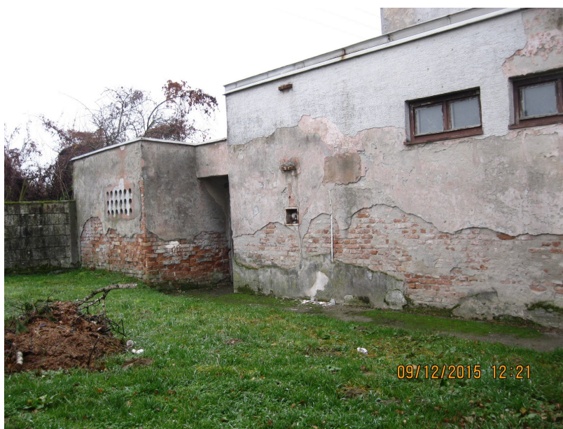
Desno: Fotografija sjeveroistočnog pročelja spomen doma i vanjskog wc-a. Stanje 9.12.2015.
